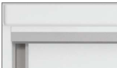
Perfil de alumínio nas portas
